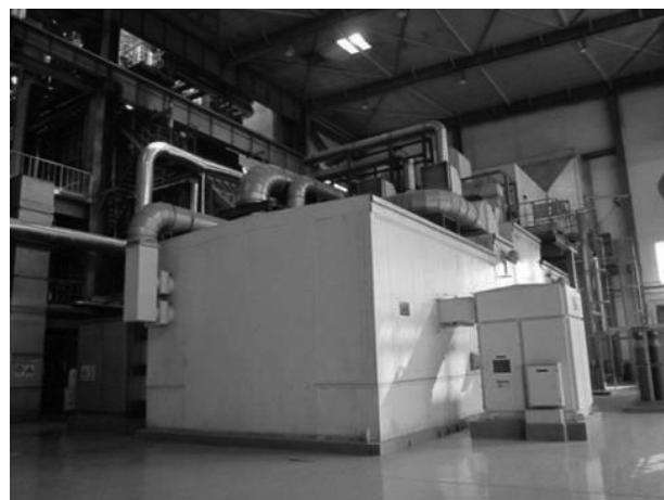
大気汚染改善に向けて円借款（北京市環境整備事業、2002年）により導入されたガスタービン
